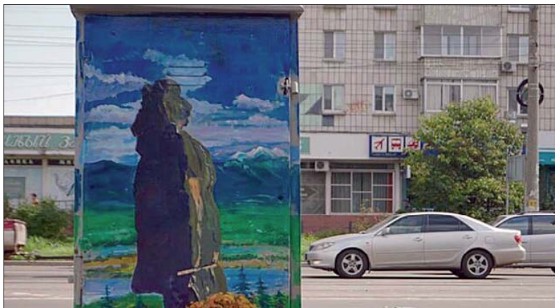
Рис. 9. Шкаф с телефонным оборудованием на центральных улицах, г. Комсомольск-на-Амуре, пр. Ленина, 48 1
